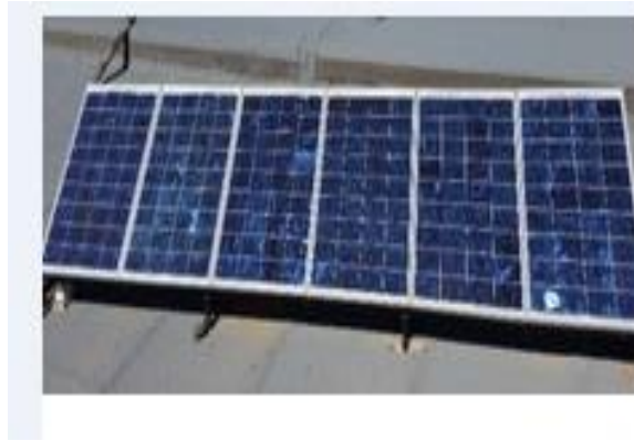
Şekil 5.3 Uygulamada kullanılan güneş panelleri
